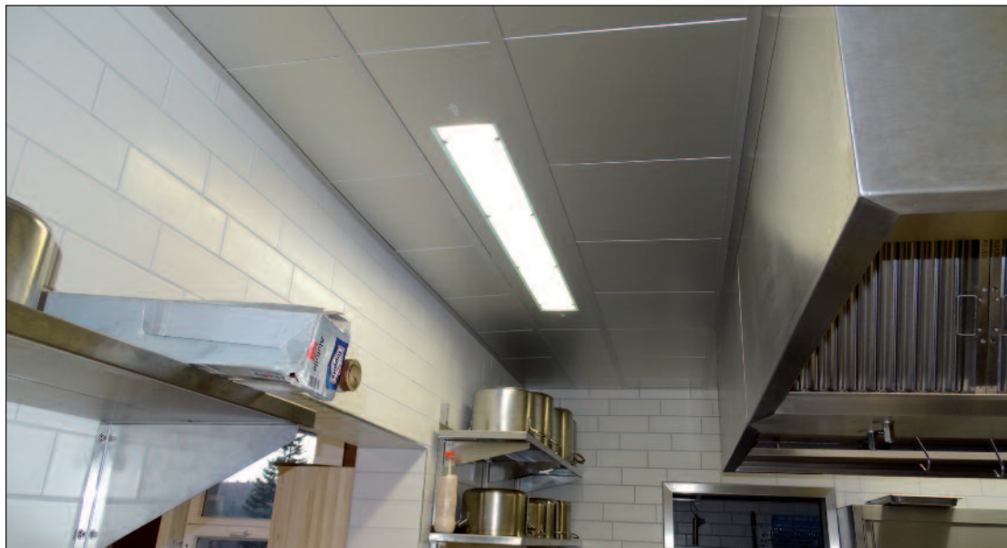
Abb.: eingebaute LED-Leuchte Fig.: installed LED lamp
